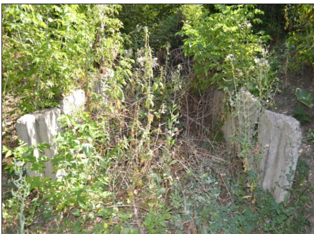
Рис. 5. Фото гідротехнічної споруди – лотка, який не виконав свою функцію, по обидві боки утворилися 2 глибокі яри
