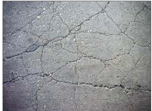
Рис. 1. Тріщини на поверхні асфальтобетонного дорожнього покриття
