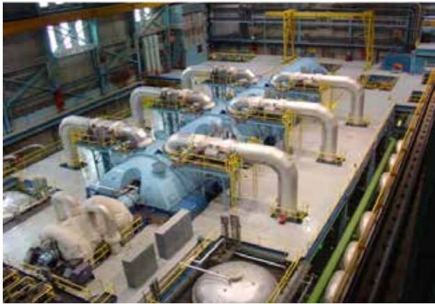
Рис. 1. Загальний вигляд машинного залу АЕС (ТЕС)
