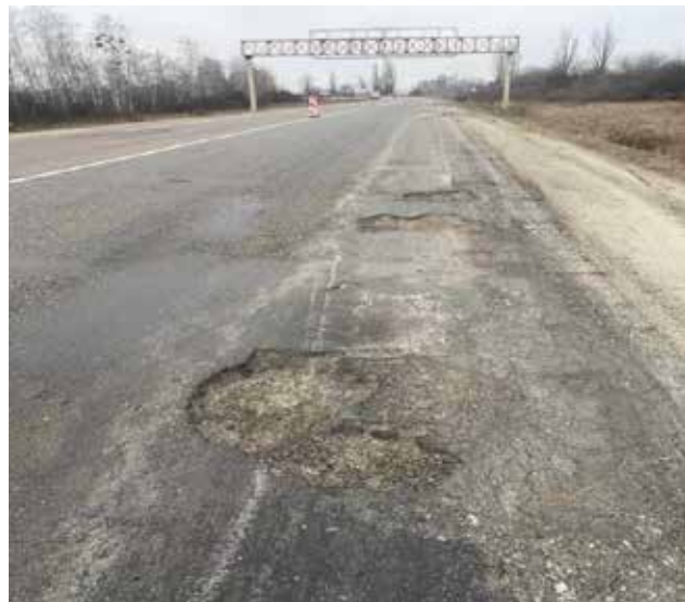
Рис. 1. Загальний вигляд ділянки дороги після закінчення зимового періоду
